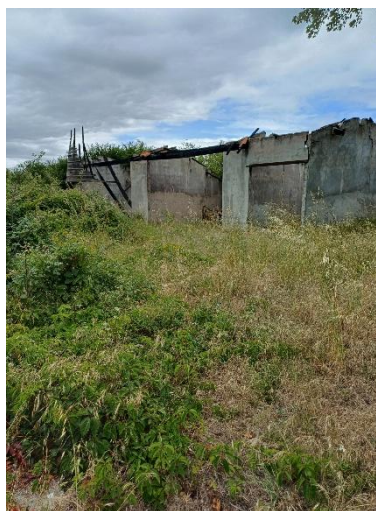
Bâtiment en ruine
